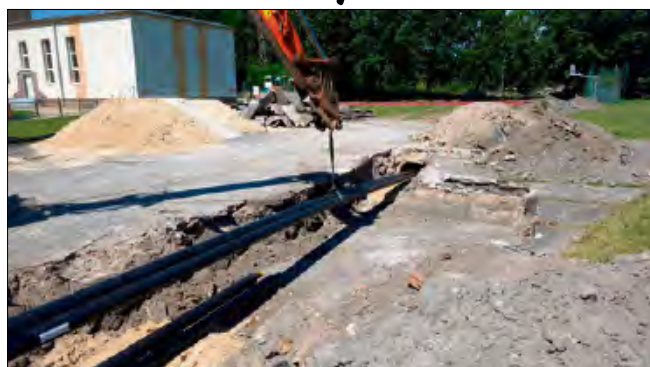
Nowa inwestycja w Ożimku ma poprawić sprawność miejskiej sieci ciepłowniczej.
