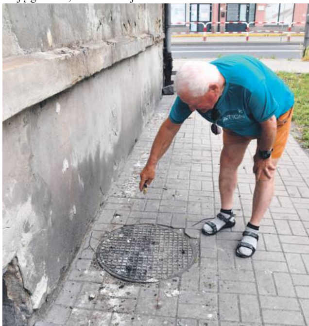
Chodnik przy budynku przy ścianie frontowej z reklamami cały czas pokryty jest warstwą ptasich odchodów - mówi pan Ryszard
