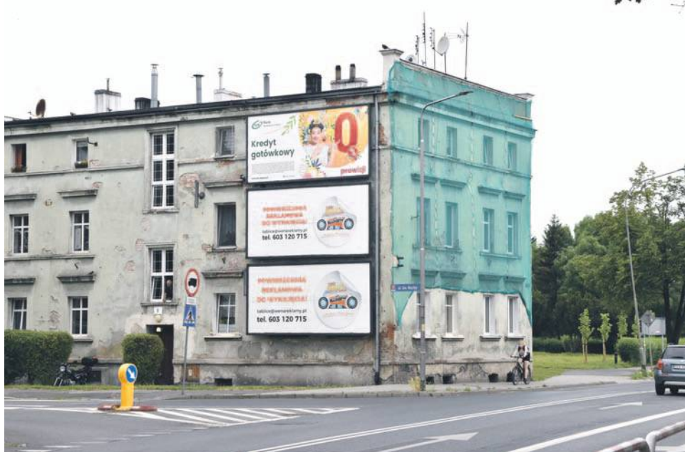
Budynek przy ul. Rocha 8 to obsypująca się elewacja, wielkie reklamy i... problemy
