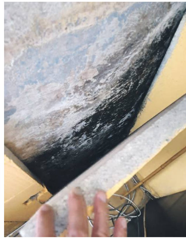
A w mieszkaniu wilgoć i taki grzyb na ścianach
