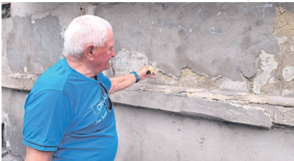
Elewacja się sypie przy każdym dotknięciu - pokazuje pan Ryszard
