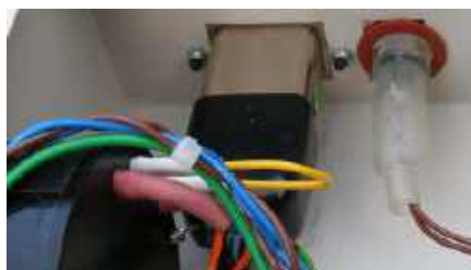
Rysunek 25. Okablowanie sieciowe. Zwróćmy uwagę na solidne koszulki izolacyjne zapobiegające porażeniu prądem
