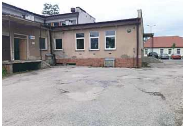
Nawierzchnia na placu szpitalnym wymaga remontu
