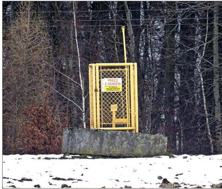
Urządzenia pierwszego odwiertu gmina ma przejąć od PGNiG.
