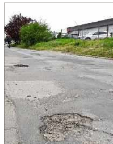
Zniszczenia widać zwłaszcza po zimie.
