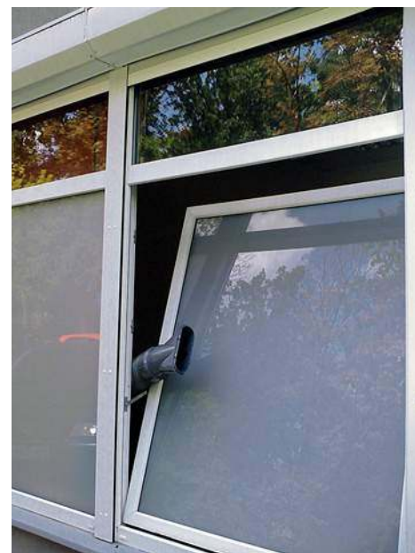
Klimatyzatory monoblokowe wymagają zapewnienia wyrzutu ciepłego powietrza poza budynek. J. ANTKIEWICZ
