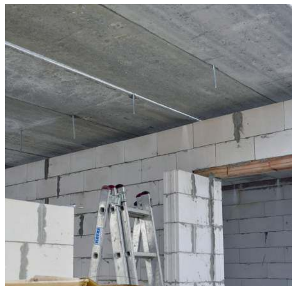
🔧 Stropy panelowe nie są narażone na klawiszowanie, na suficie nie powstają pęknięcia. STROPY.PL
