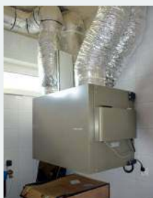
Centrala wentylacyjna znajduje się w kotłowni, w łatwo dostępnym miejscu.
