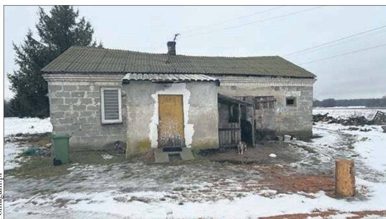
Dom mieszkańców Mochowa nie nadaje się już nawet do remontu
