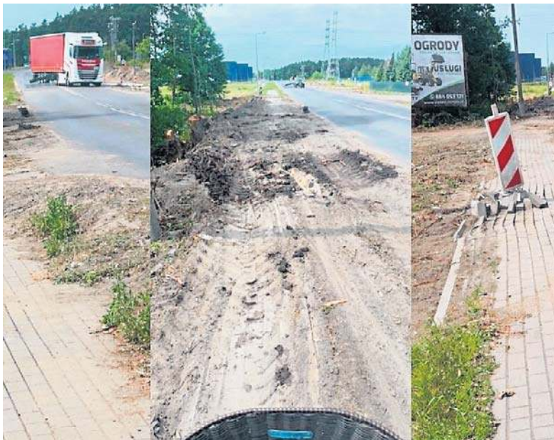
Przebudowa kluczowej drogi w Lisim Ogonie budzi wielkie emocje wśród mieszkańców
