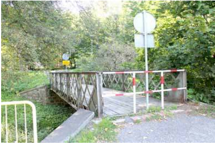
Niestety ze względu na zły stan techniczny jeszcze po kładce na Spacerowej nie przejdziemy
