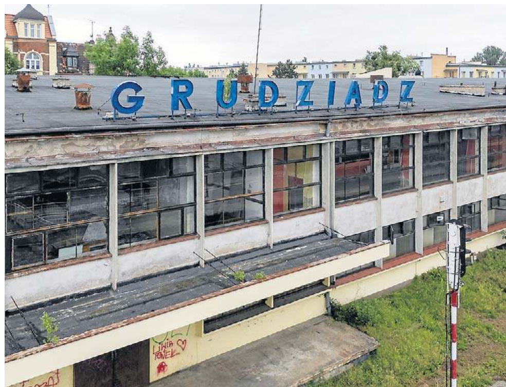
Dworzec PKP to obraz „nędzy i rozpacz”. Remontu wciąż nie możemy się doczekać!
