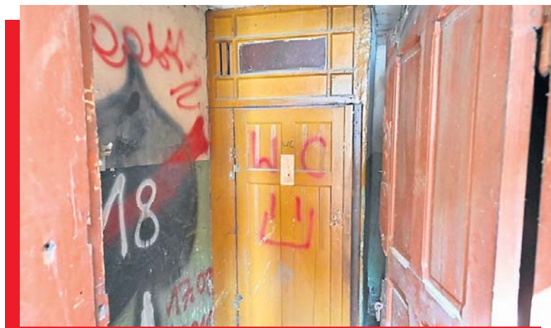
Na ostatnim piętrze znajduje się wspólna toaleta - teraz nieczynna. Dwa lata temu korzystała z niej jedna z mieszanek kamienicy.
