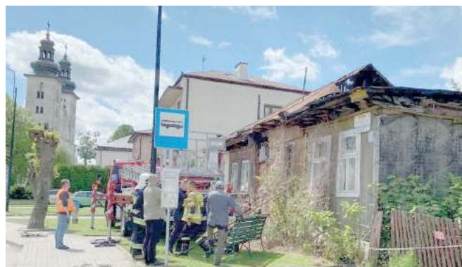
Pod koniec maja strażacy z Radzyna i Czemiernik na wniosek nadzoru budowlanego usuwali niebezpieczne elementy ze spalonego domu przy rynku w Czemiernikach
