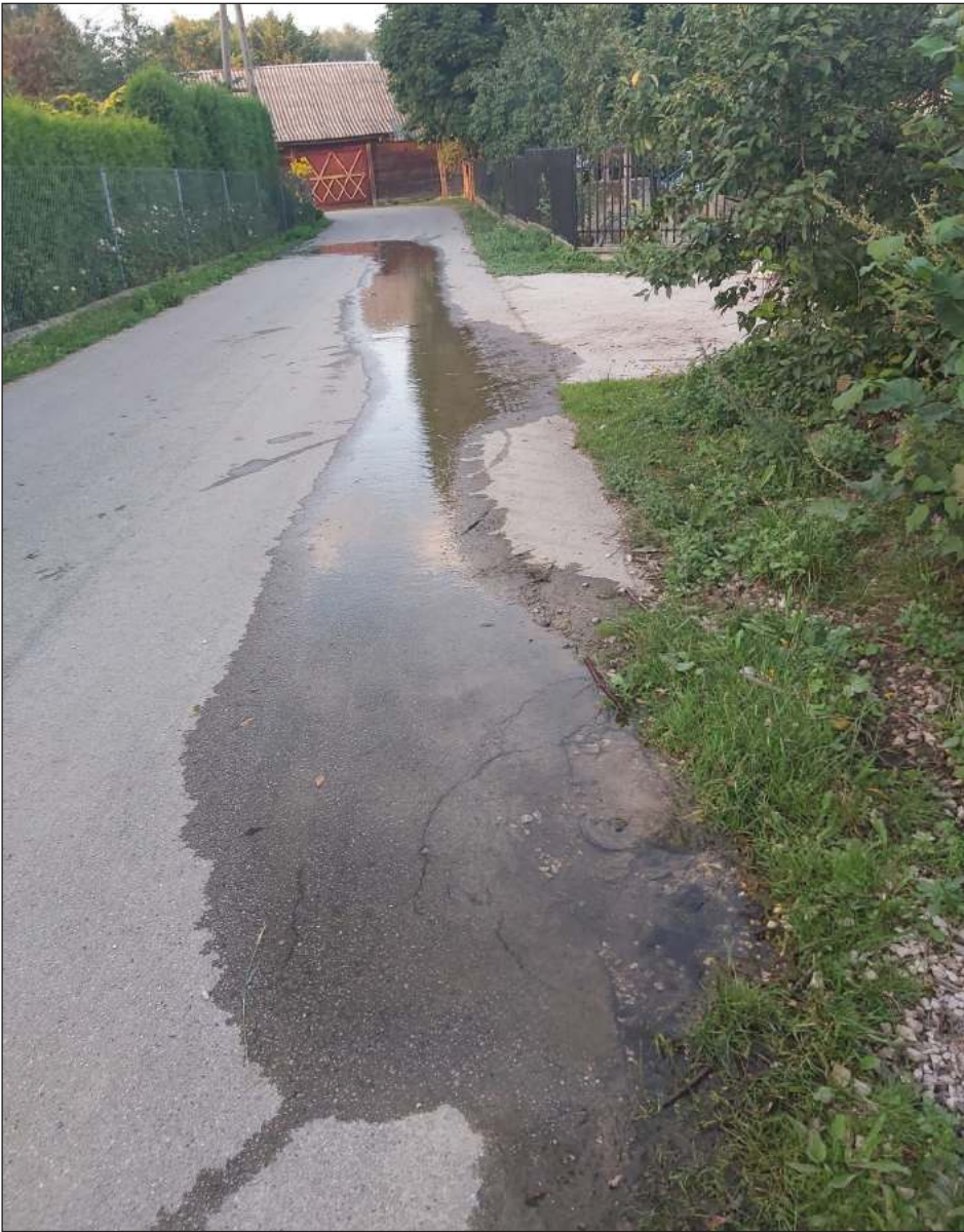
✚ Awaria na opisywanym przez nas odcinku zdarzają się regularnie. A kto płaci za wodę?
