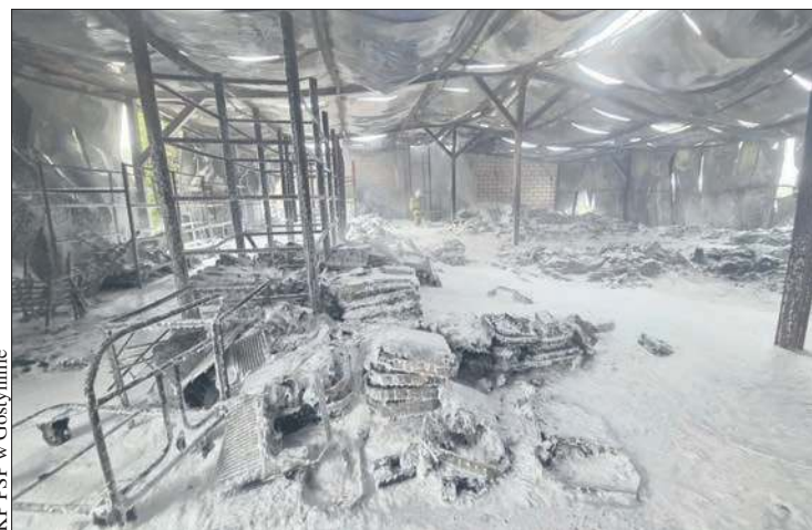
Hala przemysłowa po pożarze
