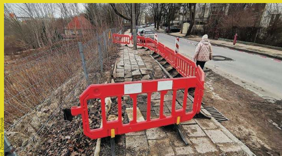
Uszkodzona skarpa i chodnik przy ul. Emilii Plater w Olsztynie
