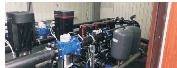
Nowe urządzenia przywrócą prawidłowe ciśnienie wody
