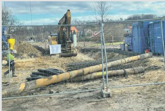
Grunty są słabonośne, dlatego musi być palowanie
