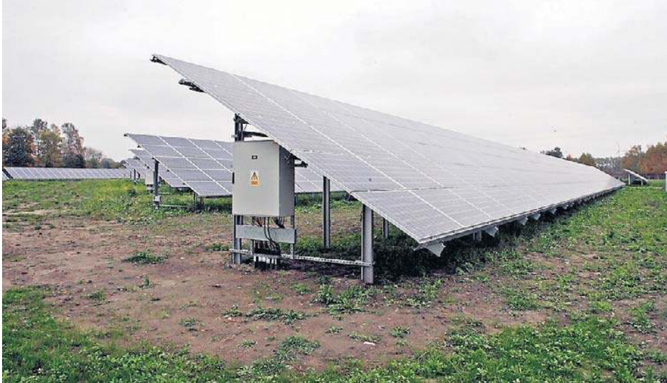
Montaż instalacji fotowoltaicznych powinien być powierzony fachowcom
