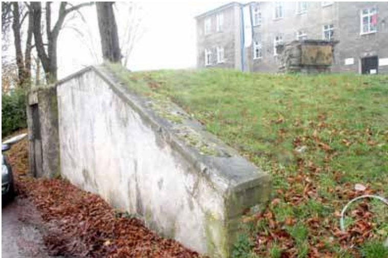
Jak widać, zakryte pomieszczenia, zwane „schronami”, są w kiepskim stanie technicznym
