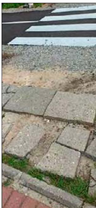
Przejście dla pieszych, a na nim popękane płyty betonowe i kamienie.
