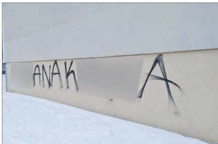
Wandale uszkodzili wszystkie bloki na ul. Tuwima.
