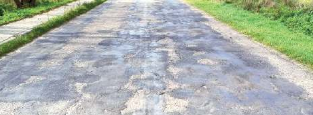
Tak aktualnie wygląda nawierzchnia drogi powiatowej biegnącej przez Łąkoć. Dzięki pomocy finansowej gminy Kurów i dotacji, jaką udało się pozyskać władzom powiatu, niebawem droga przejdzie remont
