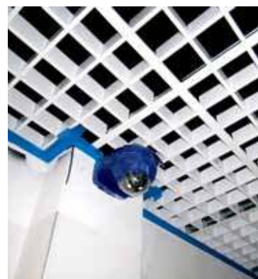
Zamontowano również kamery monitoringu
