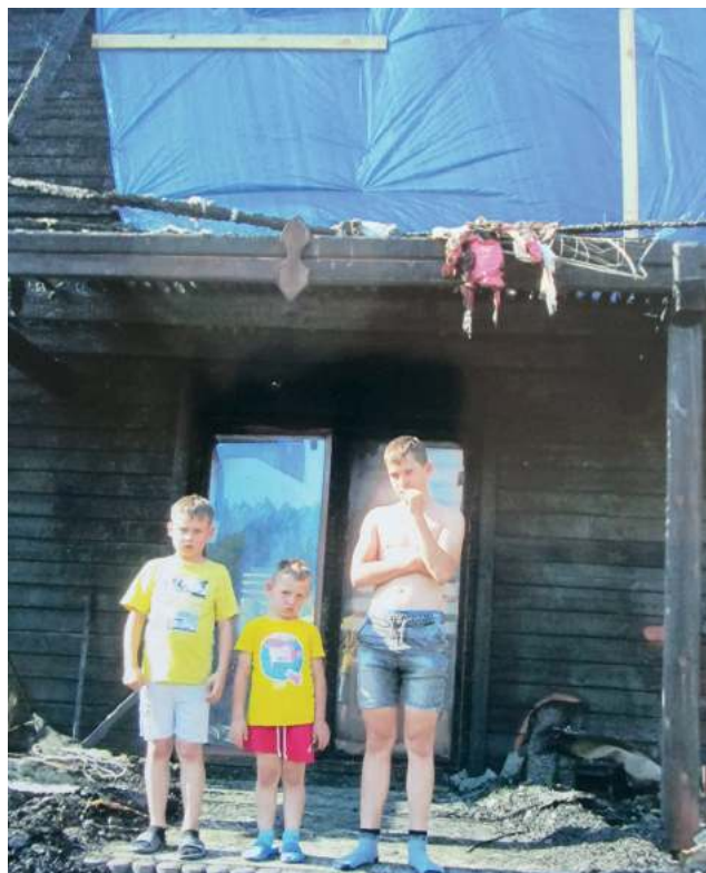
Pokoje dzieci na piętrze spłonęły doszczętnie. To dla nich rodzina chce jak najszybciej odbudować dom i zapewnić im poczucie bezpieczeństwa
