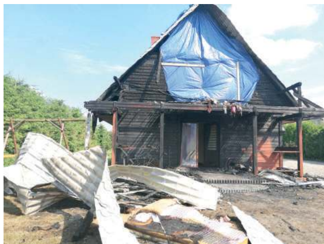
Po pożarze rodzina nie wiedziała, czy nie będzie musiała rozebrać całego domu. Teraz wiadomo, że konstrukcja parteru została nie naruszona i będzie można odbudować piętro
