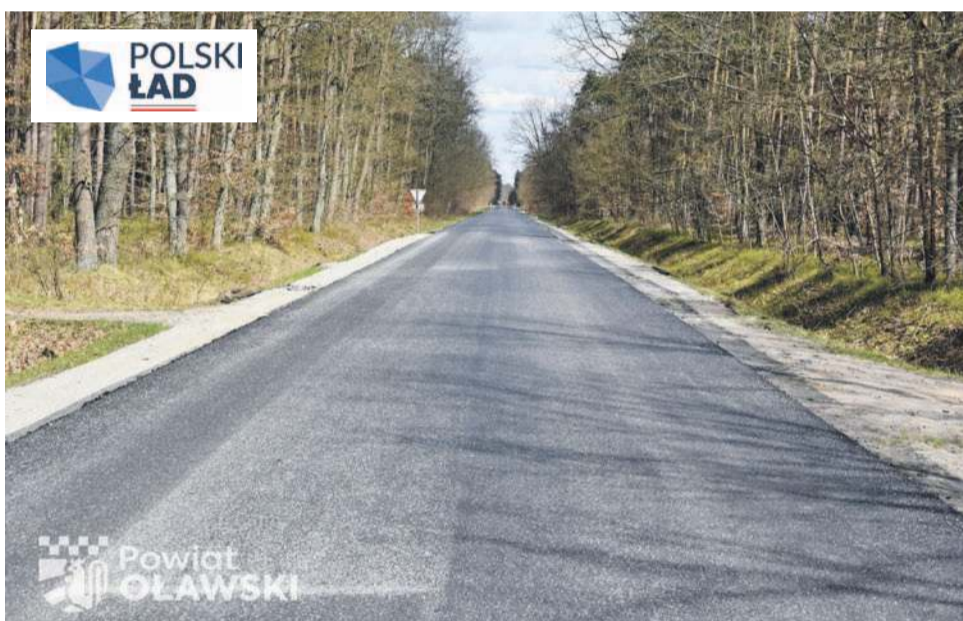
Wyremontowany odcinek drogi powiatowej nr 1548 D na trasie Minkowice Oławskie - DW nr 396 został dopuszczony do ruchu 18 kwietnia.
