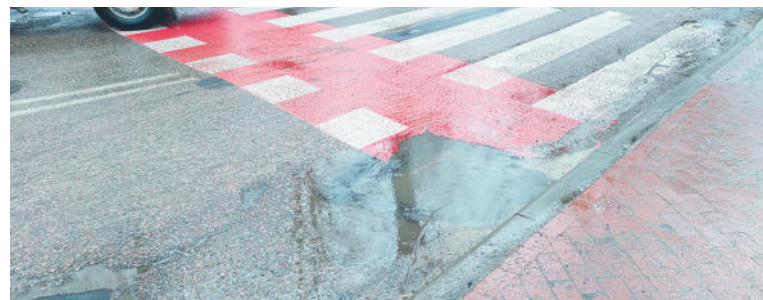
Kratka do zapchanej studzienki chowa się pod kałużę. fot. DK To w tym miejscu częsty widok.
