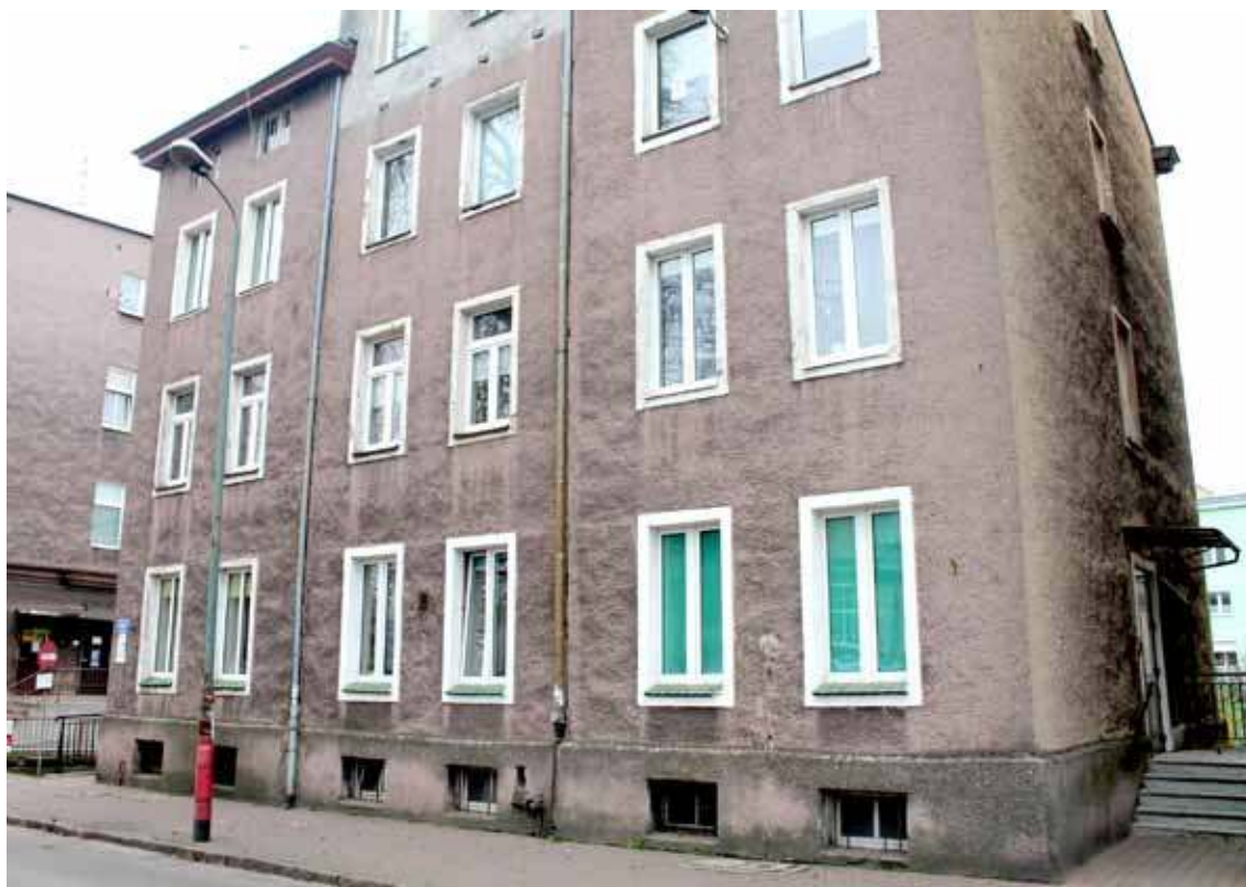
To w tym budynku, przy Dworcowej 11, mieszkańcy odczuli brak dostatecznej temperatury w mieszkaniach
