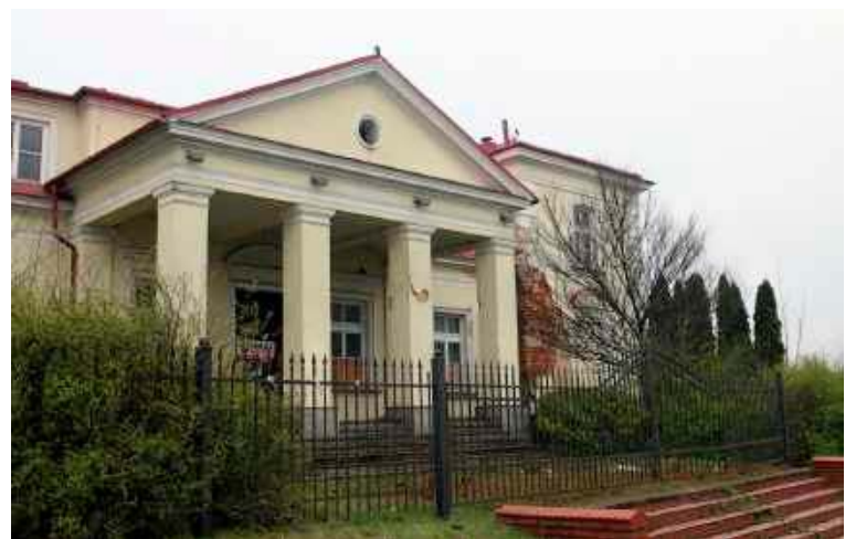
Nie tylko zdaniem naszym i społeczników z Tatar i Hajdowa-Zadębia wyłożenie przez miasto pieniędzy na remont i adaptację popadającego w ruinę Dworku Grafa (ostatnio odpadł z niego olbrzymi płat tynku) na potrzeby, którejś z miejskich jednostek, jest bardziej opłacalnym rozwiązaniem niż wynajmowanie dla nich powierzchni od prywatnych deweloperów
