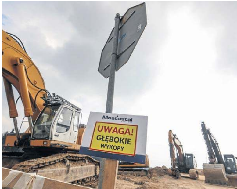
Wartość kontraktu na odcinek S19 między Domaradem a Iskrzynią przekracza 1 mld zł. Mostostal odstąpił na początku kwietnia od umowy
