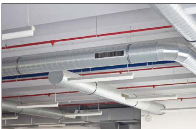
Jednym z wymogów jest stosowanie izolacji o dobrych parametrach przeciwpożarowych. Jej brak skutkuje ryzykiem, że inwestycja nie zostanie odebrana w terminie
