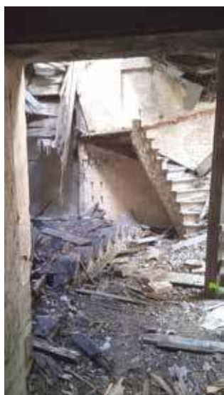
Wnętrze rezydencji - zawalone schody.
