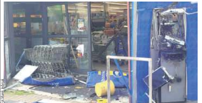
Skutki eksplozji podłożonego ładunku wybuchowego były tak silne, że zniszczeniu uległ bankomat i drzwi wejściowe do sklepu Stokrotka przy ulicy Tatarakowej w Lublinie
