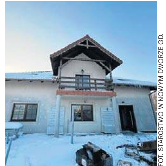
W obecnym stanie dom nie nadaje się do użytku
