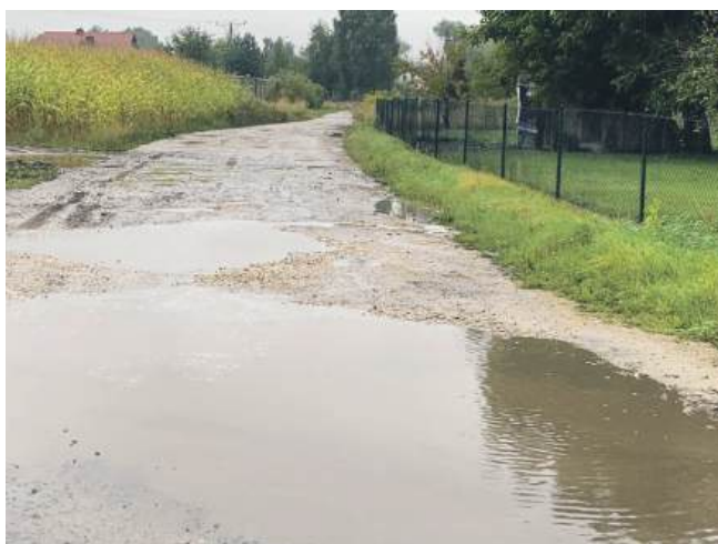
Niektóre drogi od lat toną w błocie
