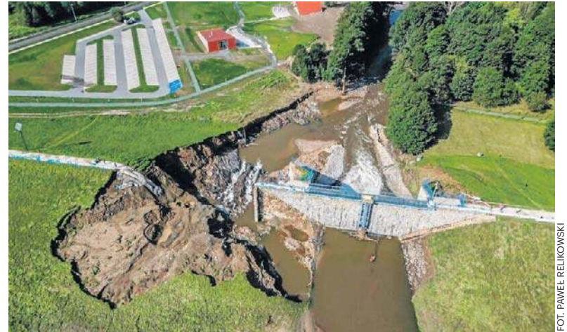
Przerwana zaporą w Stroniu Śląskim (wrzesień 2024 r.)
