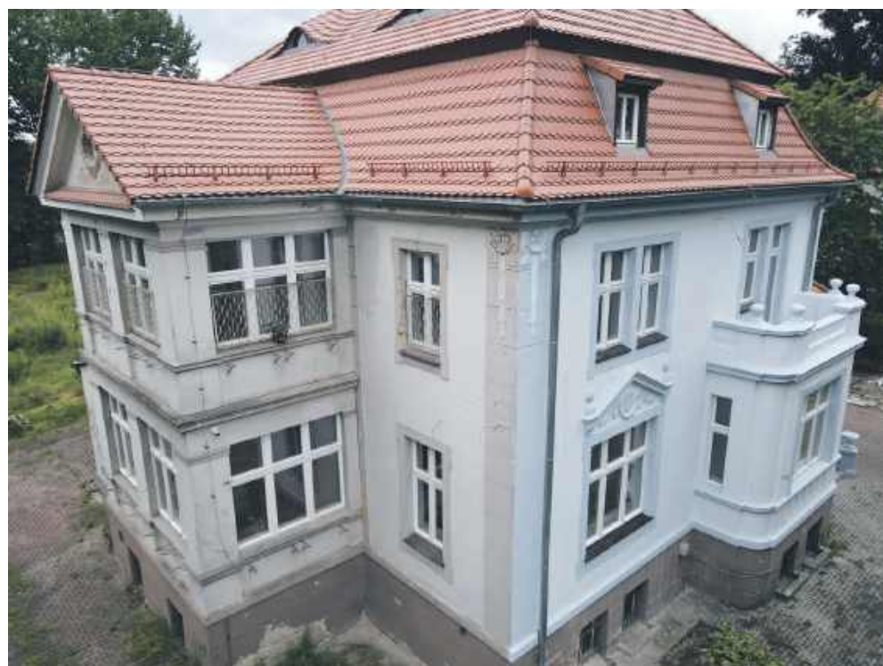
Jak widać, jedna ściana nie została wyremontowana
