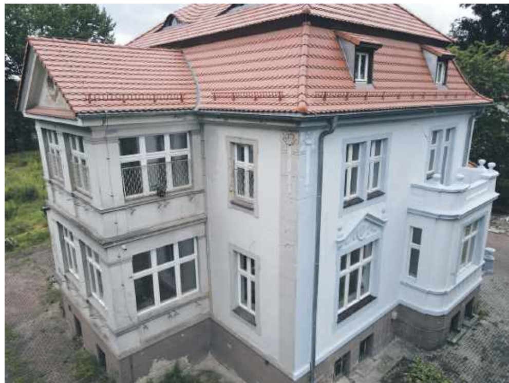
Jak widać, jedna ściana nie została wyremontowana
