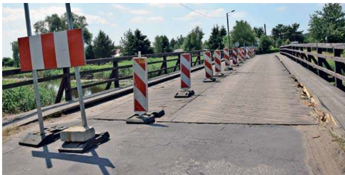
Nowy most ma zastąpić lichą drewnianą konstrukcję (fot. powiat nowosolski)
