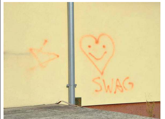
Zniszczoną elewację budynku remizy strażackiej uznali za akt wandalizmu
