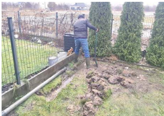
Mieszkańcy radzą sobie, jak mogą. Sami kopiują prowizoryczne odwodnienia
