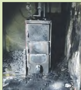
Spalona część kotłowni
