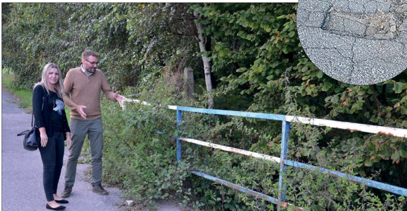
Radny miejski Jakub Elsner oraz radna dzielnicy Izabela Sankala – Ciuberek wskazuje, że dziura oraz ogólny stan przepustu na ul. Chełmońskiego stwarza zagrożenie dla bezpieczeństwa pieszych i kierowców
