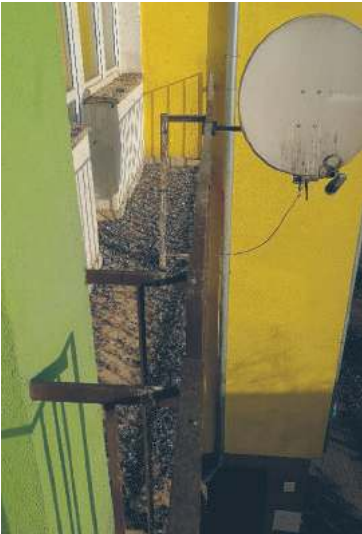
Balkon pokrywa gruba warstwa śmierdzących gołębih odchodów, stanowiących siedlisko dla bakterii, wirusów i grzybów
