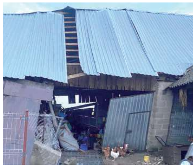
W Mizarach (gm. Stoczek Łukowski) w wyniku burzy dachy trzech budynków gospodarczych zostały całkowicie zerwane, a jeden z budynków uległ częściowemu zawaleniu (fot. OSP Zgórznica)
