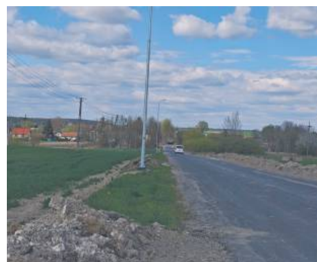
Wola Siennicka - modernizacja oświetlenia ulicznego.
