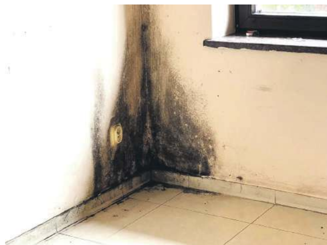
Grzyb na ścianach
