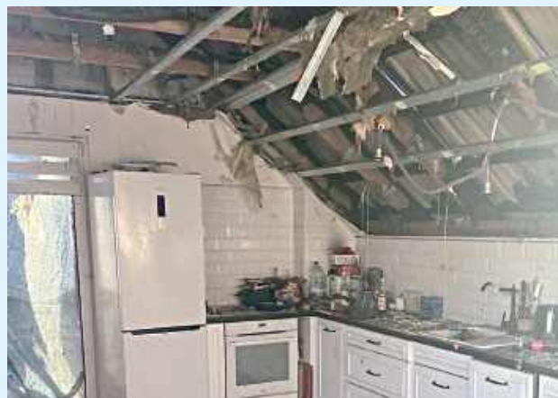
Całe poddasze budynku wymaga gruntownego remontu
