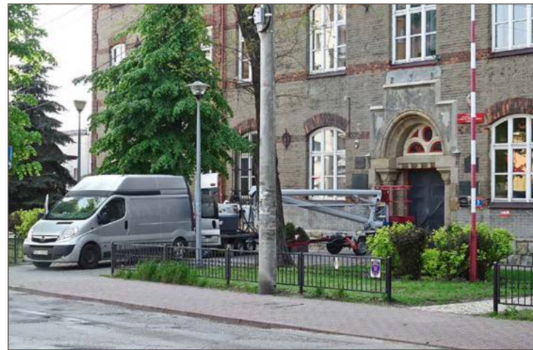
Budynek I Liceum Ogólnokształcącego w Dębicy wymaga remontu.
