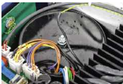
Fundamentem zasilacza jest duży transformator toroidalny.
