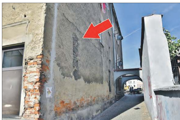
Ulica Ciasna od strony ul. Jagiellońskiej. Nieotynkowany fragment ściany to ślad po przyporze łuku.
